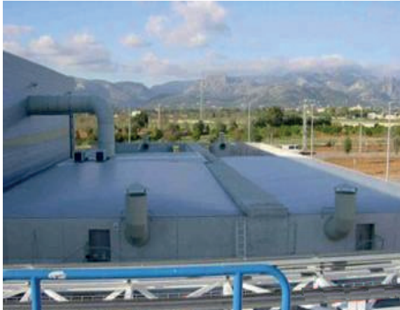
Fig 2. Biofiltro Avanzado BBK en una planta de biodigestión de RSU y fangos EDAR.
