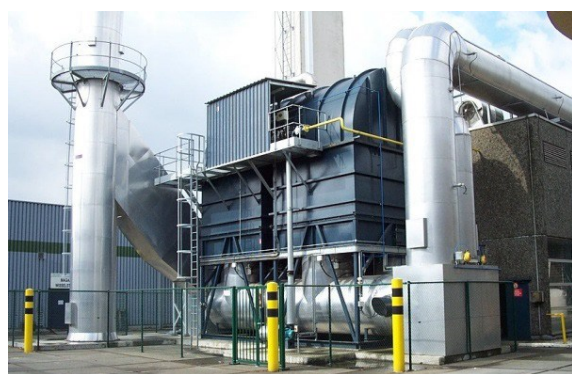
Figura 3. RTO de 2 lechos para 80.000m 3 /h
