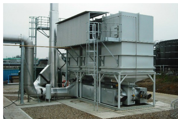
Figura 5. RTO de 3 lechos para 26.000m 3 /h
